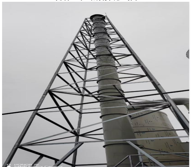
现有工程污水处理站排气筒
