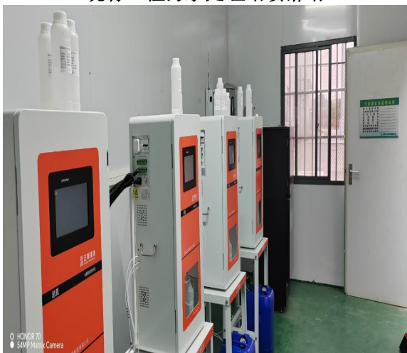
现有工程废水在线监控设备
