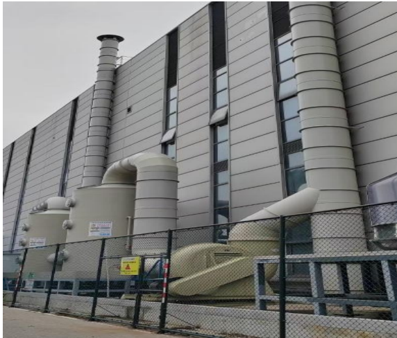
现有工程铬酸雾处理设施
