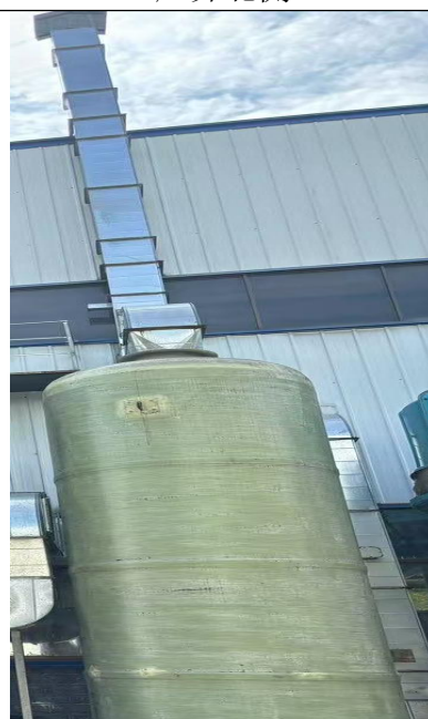
二级活性炭吸附+DA002 排气筒
