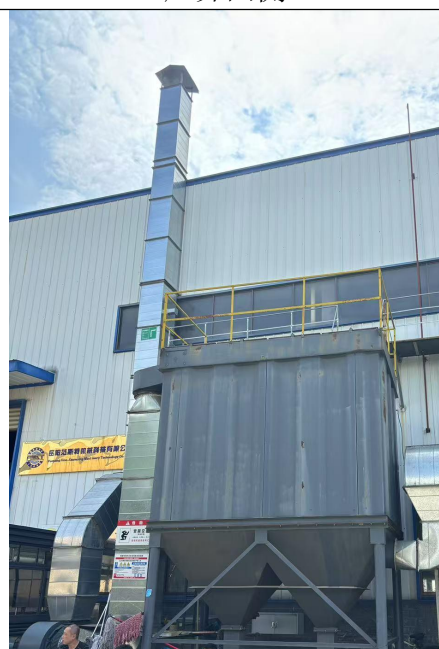
布袋除尘器+DA001 排气筒
